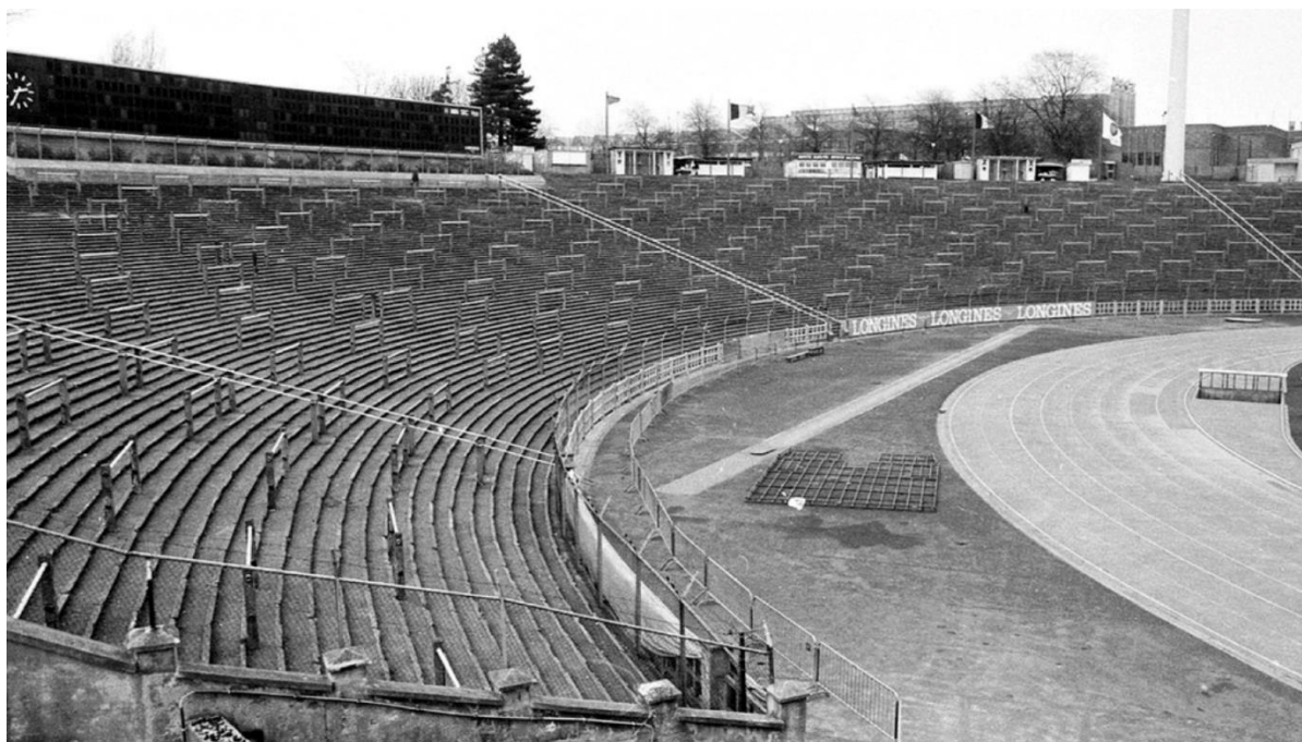
Figura 3 - Estrutura velha e deteriorada do estádio, às vésperas do jogo
